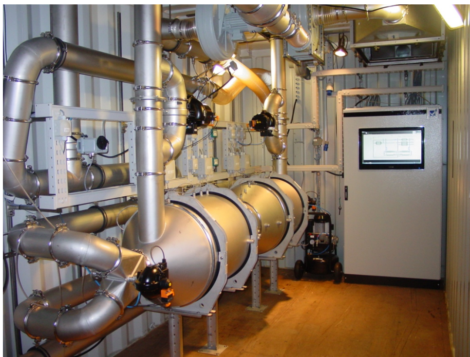
Figur 3. CLMO anlægget er et kompakt aggregat opbygget, både af standard komponenter, og af CAD/CAM specialproducerede dele fra EU-området og Kina som et autonomt selvstyrende system i en container med selvstændig instrumentering.
